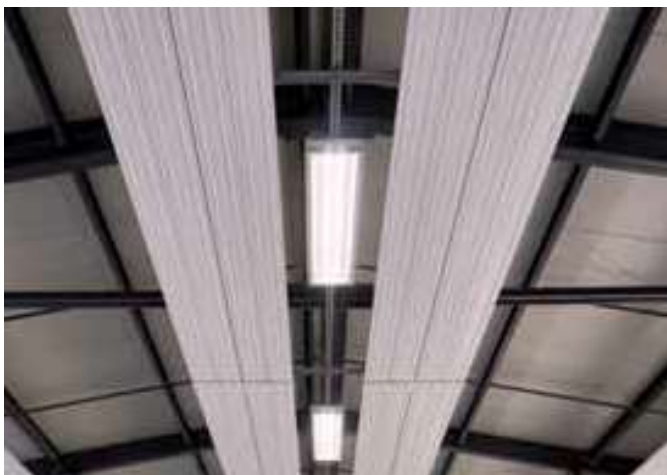
Das KIT Classic Sortiment umfasst die Standardlängen 2, 3, 4 und 6 m. Aus den Grundmodulen entstehen bei Bedarf vier Breiten von 330 mm bis 1.338 mm. Hier ein Anwendungsbeispiel der Variante NG (no gap) in einer Industriehalle.
