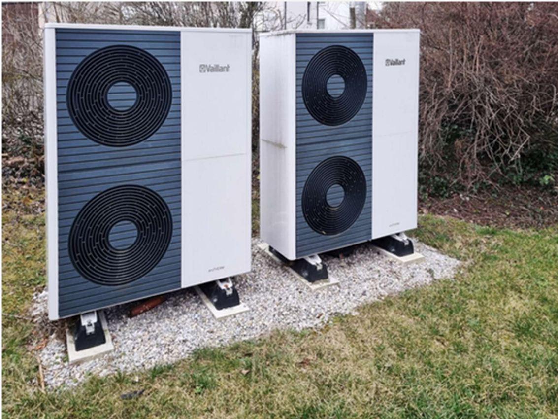
Die Wärmepumpen aus dem Hause VAILLANT arbeiten als Hybridanlage in Kombination mit einem Gas-Brennwertgerät.
