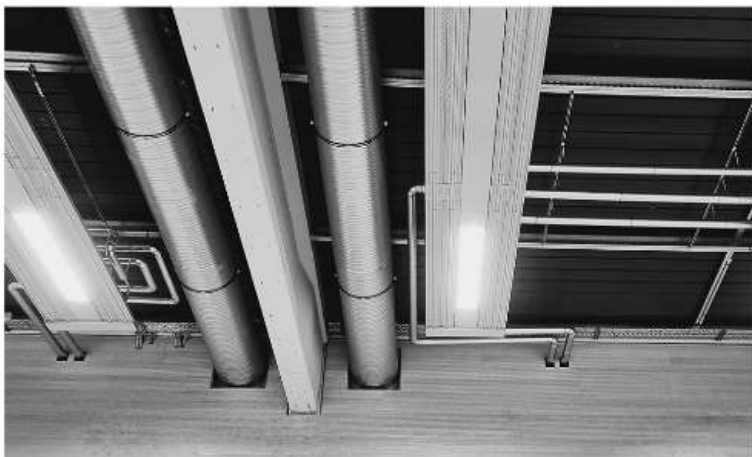
Zahlreiche Versorgungsleitungen laufen unter der Decke, auch der Vor- und Rücklauf für die Deckenstrahlplatten. FOTO: RMBH
