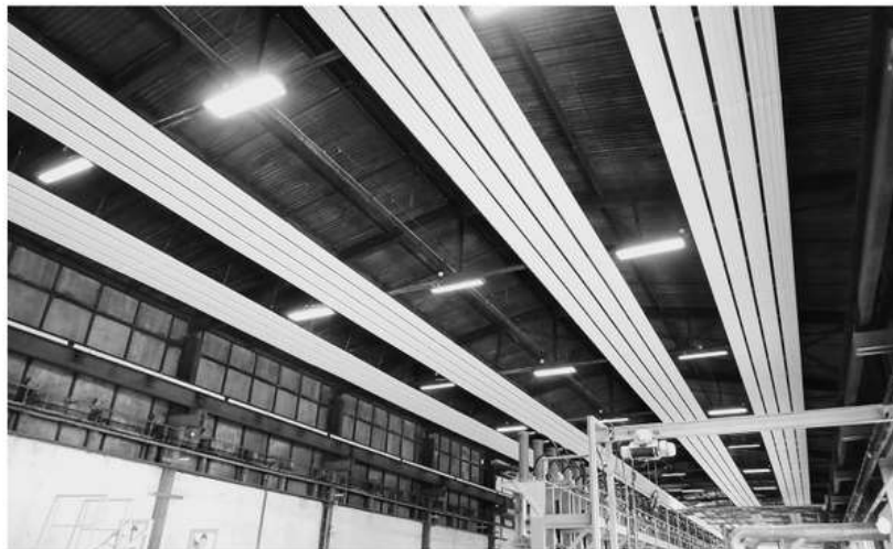
Die KIT Classic IV, zusammengesetzt aus dem Grundelement KIT I, erwärmt eine Industriehalle.
