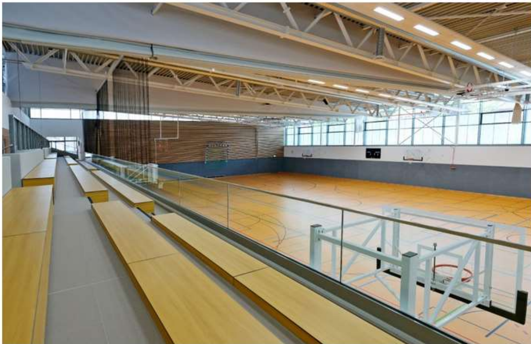
Die Deckenstrahlplatten mit integrierten LED-Leuchten reichen bis über die Zuschauertribüne. Foto: RMBH GmbH
