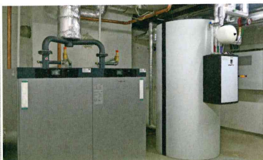
Herzstück der Heizungsanlage: die Zweier-Kaskade und ein Pufferspeicher mit Frischwasserstation.
