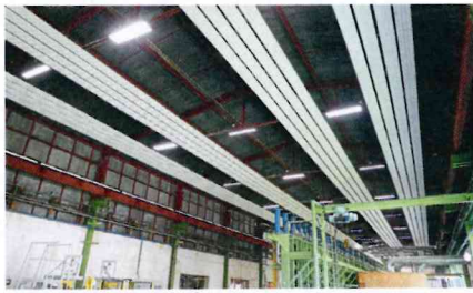
Eine Halle wurde mit „Radia Expert Kit“ ausgestattet.
