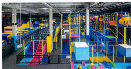
Scheinbar schwebende Deckenstrahlplatten unter der Decke der Trampolinhalle.
