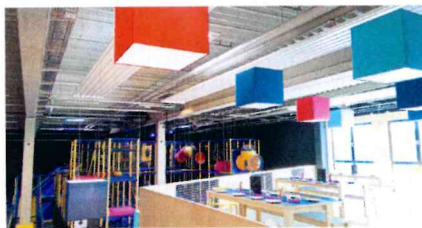
Konstante Wärme über das gesamte Areal der Empore.
