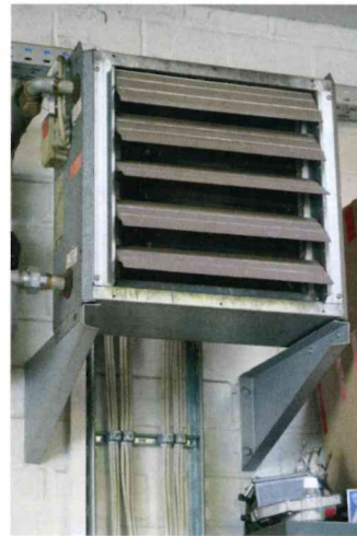
Ein Luftheritzer gibt die erwärmte Luft durch die Lamellen in den Aufstellraum ab.
