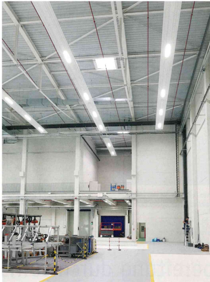
In dieser Industriehalle wurde eine Kombination von Deckenstrahlplatten und Premium-LED-Leuchten installiert.
