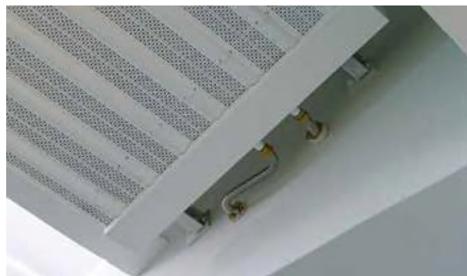
Vor- und Rücklauf sind mit flexiblen Schläuchen ausgeführt, zum Schluss wird die Abdeckung aufgesteckt.
